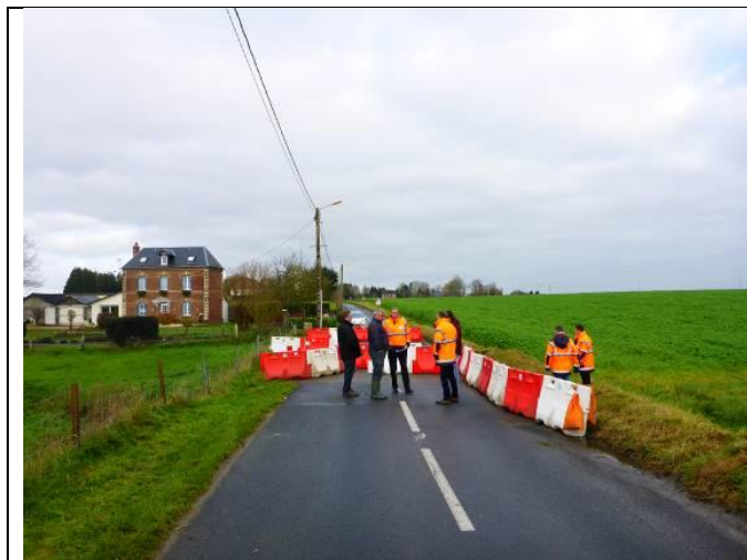
Avant effondrement de la RD63 à Saint-Paër
