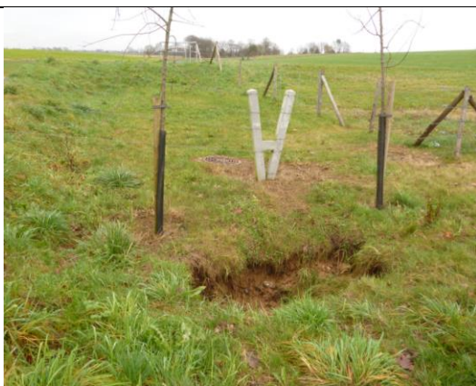
Suspicion de bétoire au niveau de de l'accès à l'ouvrage BV_02
