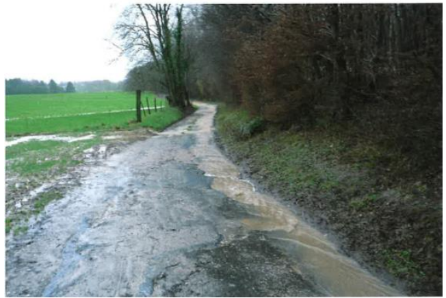
2018 - Chaussée fortement dégradée
