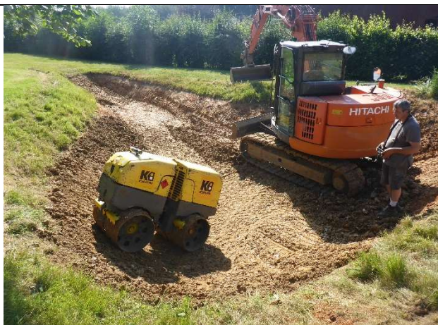
La mare ne tenant toujours pas l'eau, des travaux de reprises ont été fait (apport d'argiles + compactage). C'était notre dernière tentative. Le propriétaire nous a informé que la mare tenait un peu mieux l'eau
