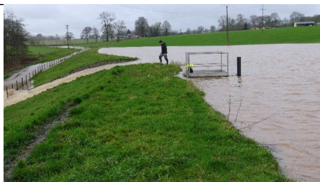
Barrage MP_03-4 en limite de la surverse généralisée (risque important pour la structure du barrage)
