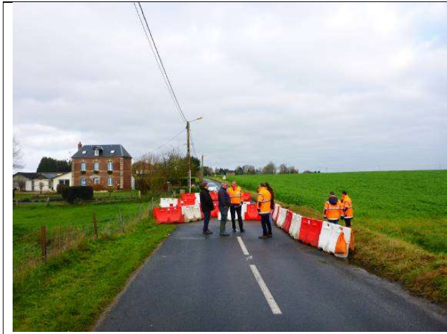
Effondrement de la RD63 à Saint-Paër
