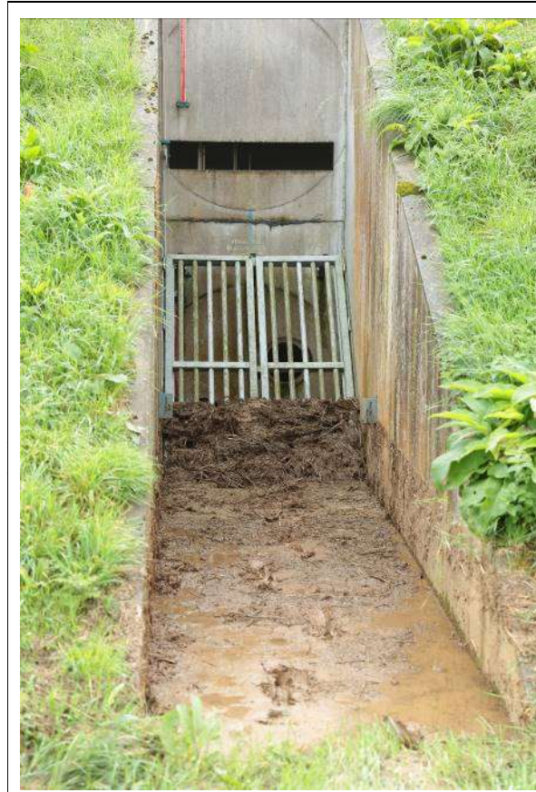
Envasement de l'ouvrage BV 01 suite à un retournement d'herbage sur forte pente
