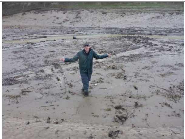
Envasement de l'ouvrage - constat post-crue
