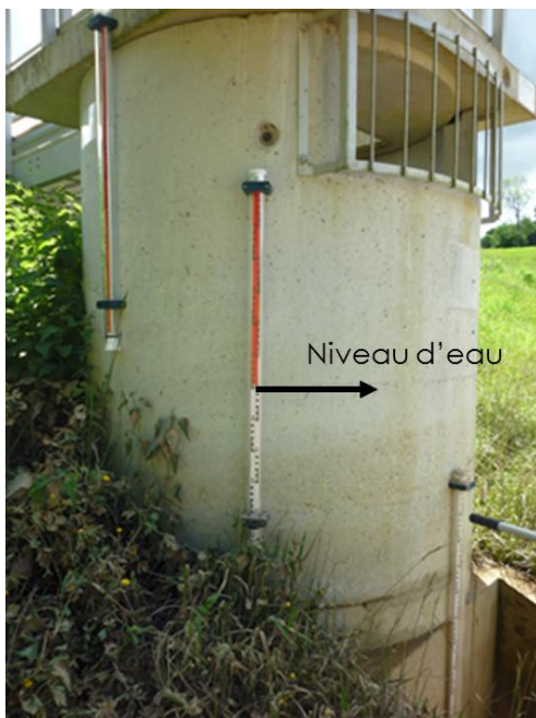
Exemple d'échelle à maxima permettant d'avoir une trace nette de la hauteur d'eau atteinte dans l'ouvrage
