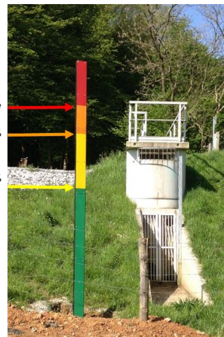
Exemple d'échelle colorée permettant de voir rapidement la hauteur d'eau atteinte dans l'ouvrage
